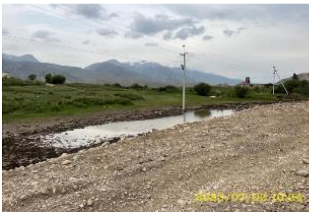
Фото 113. Объездная дорога моста на км 86+261. р. Саздын-Суусу, требуется рекультивация и осушение прилегающего участка, затопленного вследствие устройства объездной дороги
