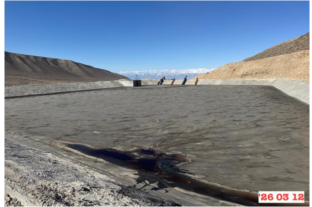
Битумохранилище на производственной базе км.202+220
