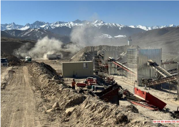
Фото 55. Производственная база, км 202+220 RHS, отсутствие гидроорошения внутрипроизводственных дорог
