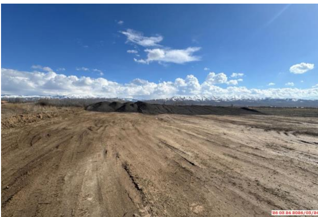
Фото 65. Отвал асфальта на км.199+500, складирован на грунтовой поверхности без обустройства защиты от загрязнения, не обеспечен водоотвод.
