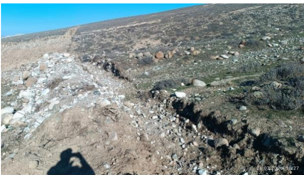
Битумохранилище на производственной базе км.202+220. Обеспечен водоотвод от битумохранилища
