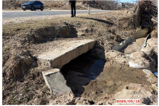
Фото 20. Селепропуск на км.151+020 LHS. ВЫХОД
