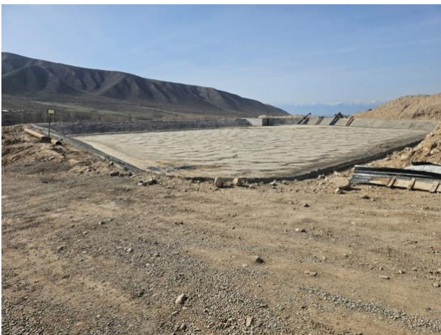
Битумохранилище на производственной базе км.202+220
