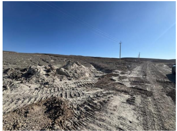
Фото 70. Производственная база км.167+360, не обеспечен селеотвод от базы.
