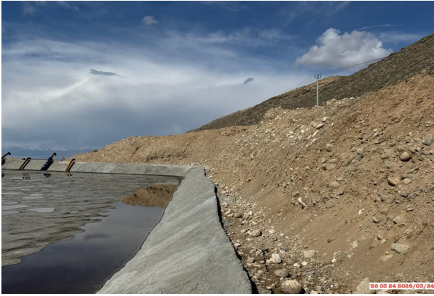
Битумохранилище на производственной базе км.202+220
