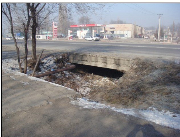
Канал сбросной в с. Ново- Павловка
