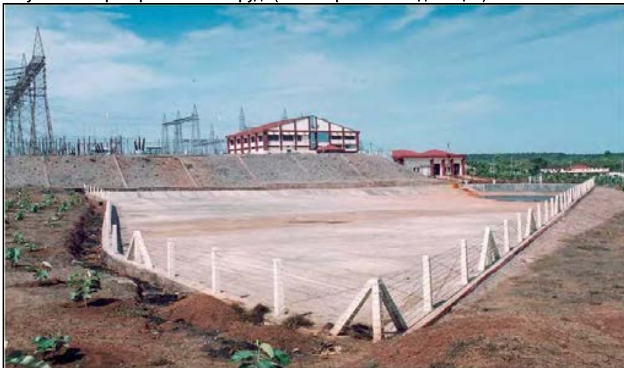
Рисунок 6.14: Пример отстойного пруда (на электрической подстанции)
