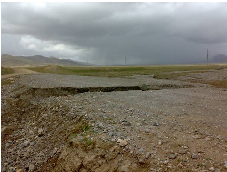
Рисунок 10: Трасса, разрушенная в результате схода селя на км 460.
