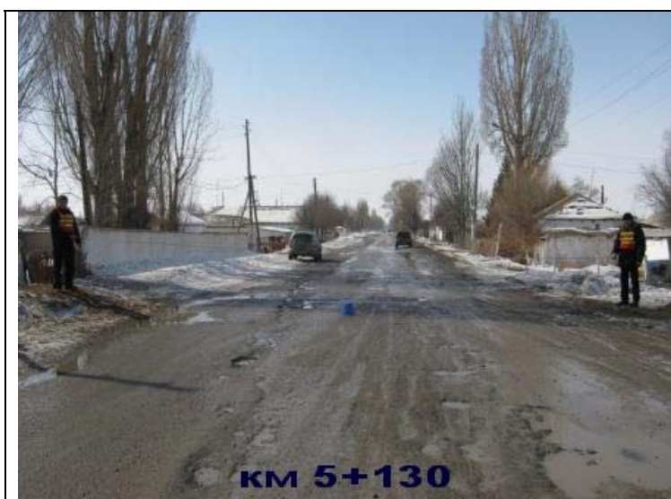
Рис. 38 Показана ось дороги и 10 м ширины дороги. Трогуары асфальтированные не везде видны, поскольку местами они разрушены, кое-где они пролезают по грунту, местами не видны из-за снежных сугробов
