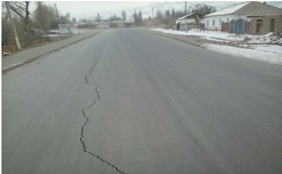
Рисунок 1: Трещины, вызванные морозным пучением на км7+400-7+420, 22-января
