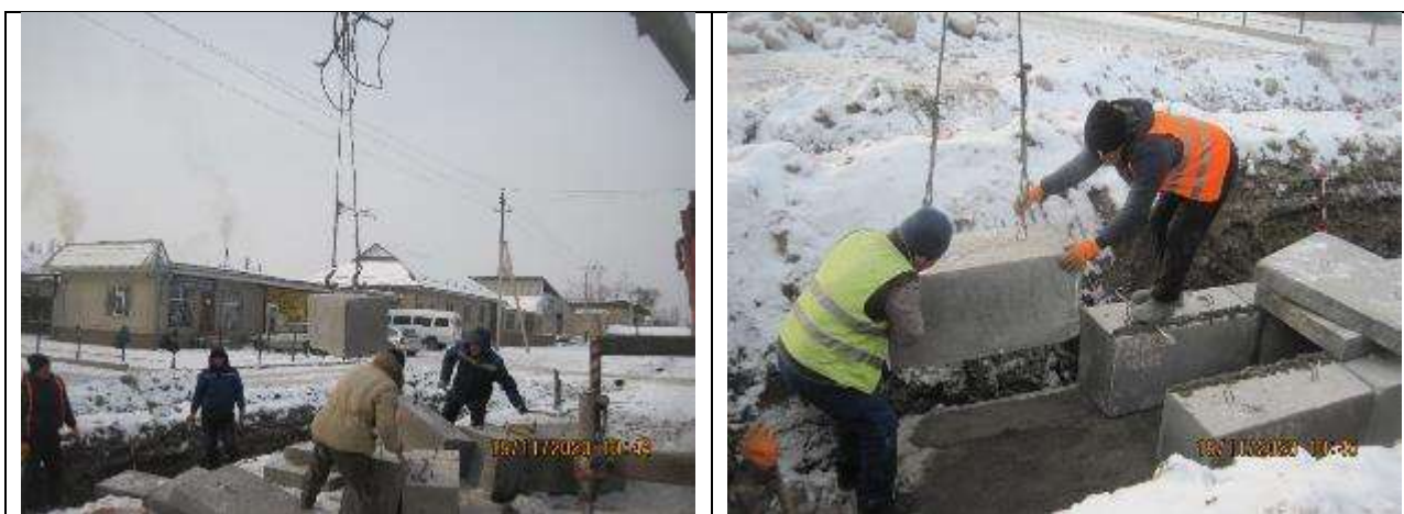
Рисунок 33 Нарушение техники безопасности при установке водопропускных лотков
