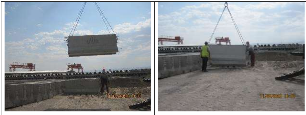
Рисунок 46 Нарушения техники безопасности при работе с краном. Отсутствие средств индивидуальной защиты
