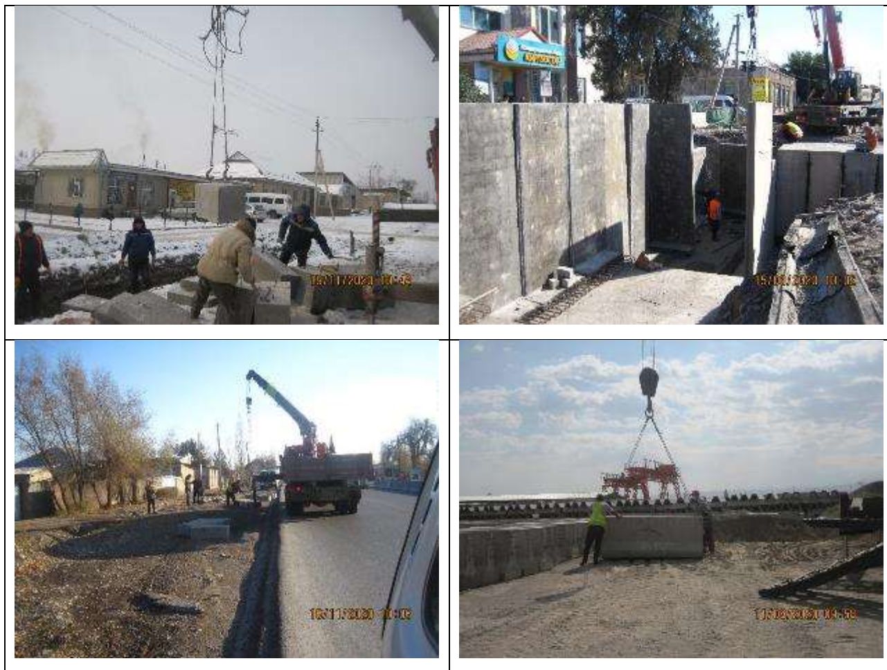
Рисунок 77 Нарушения техники безопасности при перемещении грузов подъемным краном и работе на высоте
