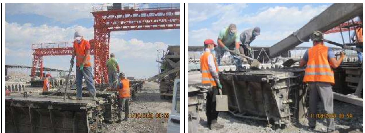
Рисунок 47 Отсутствие средств индивидуальной защиты у рабочих на полигоне изготовления железобетонных изделий при подъеме и перемещении груза
