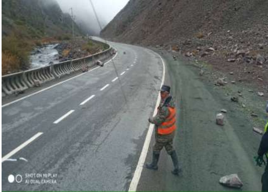
Рисунок – 4. Очистка дорог от мусора и камнепадов - текущий ремонт дорожной одежды (ямочный ремонт, заливка трещин, чистка); Участок 61 км-121 км
