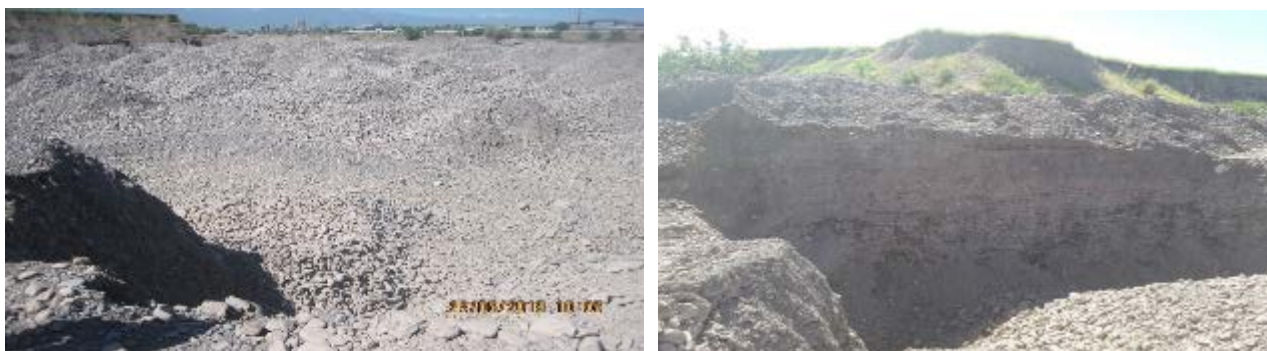
Рисунок 10. Нарушение глубины разработки при повторном открытии карьера Кара-Балта
