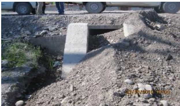
Рисунок 12. Новые водопропускные трубы, перекрытые мусором.
