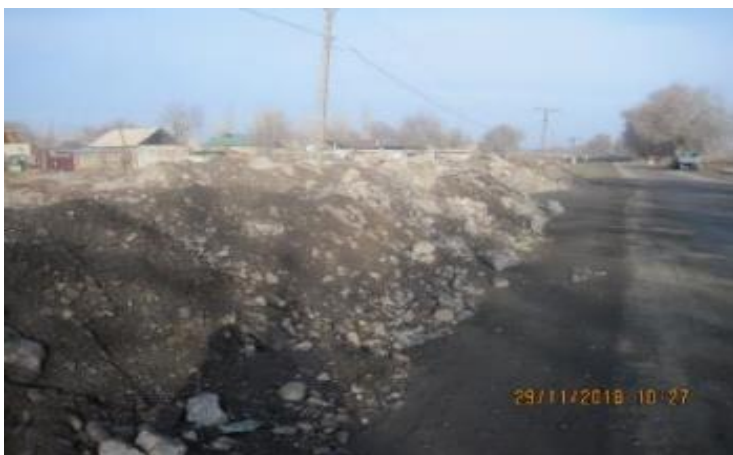
Рисунок 30 Строительный мусор на северной стороне строящегося моста
