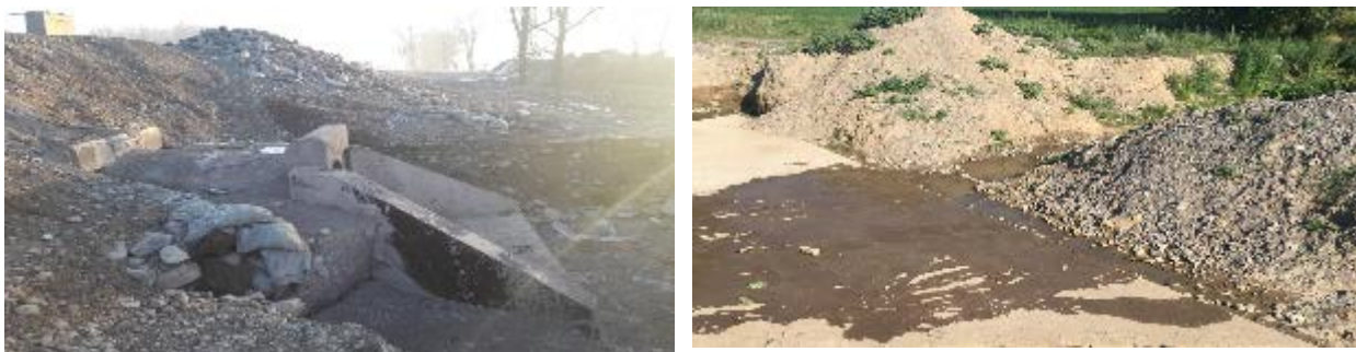
Рисунок 29. Водопропускная труба с добавленной дополнительной секцией и блокировка моста на реке Желамыш
