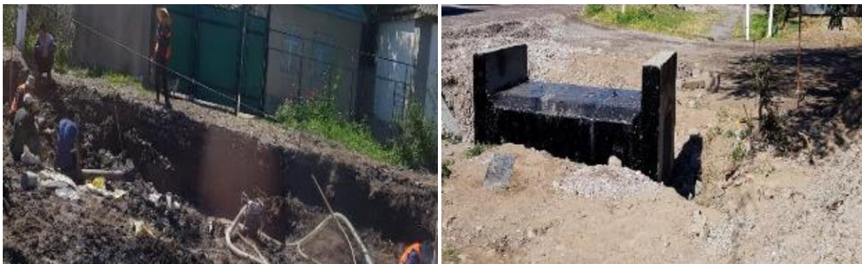
Рисунок 20. Проведение строительных работ с нарушением правил безопасности, село Александровка
