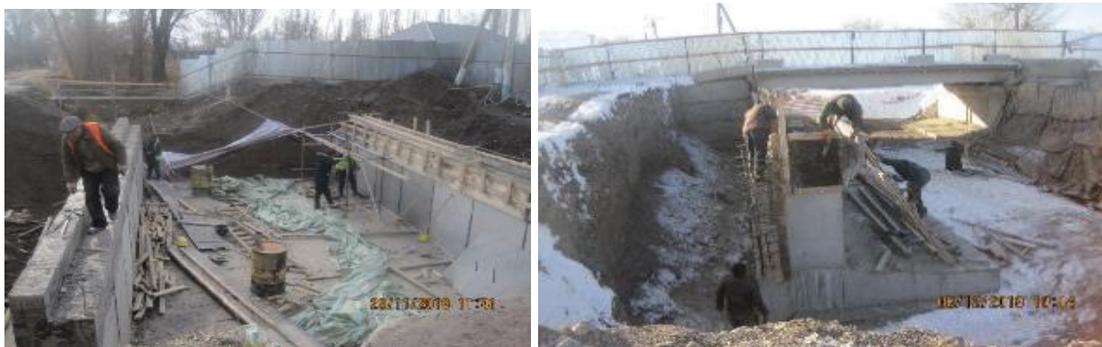
Рисунок 42. Проведение работ на высоте без СИЗ
