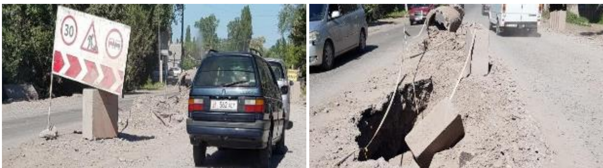
Рисунок 21. Проведение строительных работ с нарушением правил безопасности, село Беловодское
