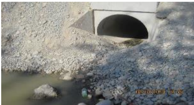
Рисунок 28. Мусор почти полностью перекрыл входные отверстия водопропускной трубы
