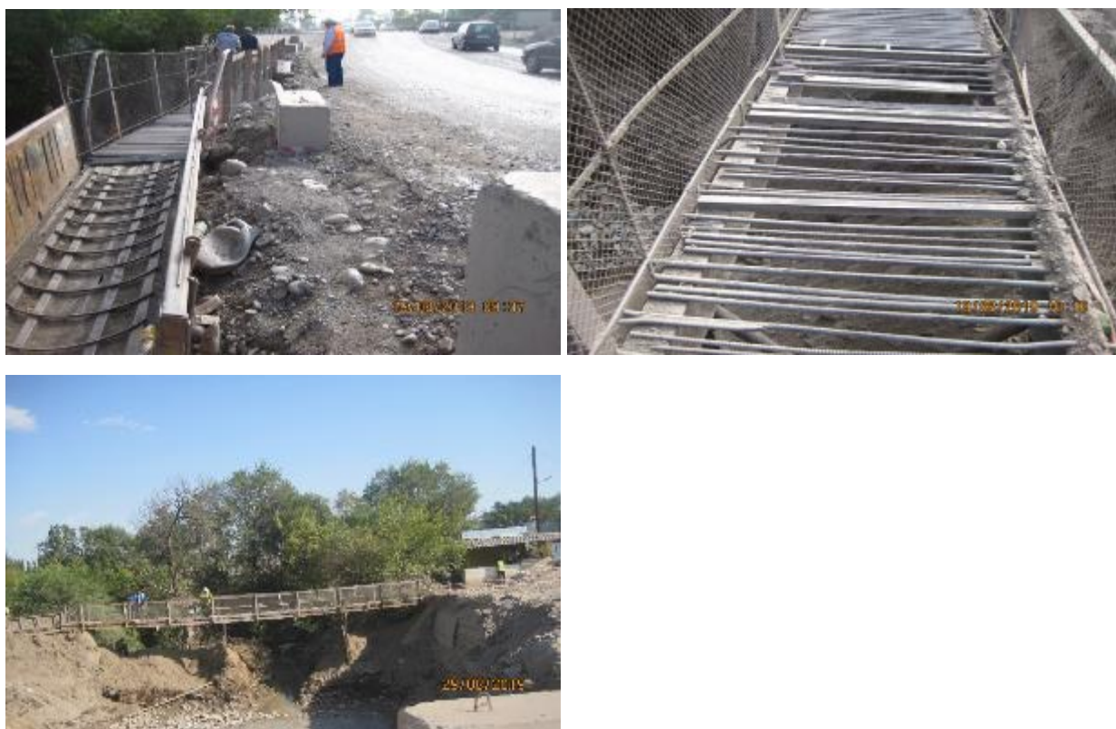
Рисунок 34 Нарушения при строительстве пешеходного моста на канале Крепостной
