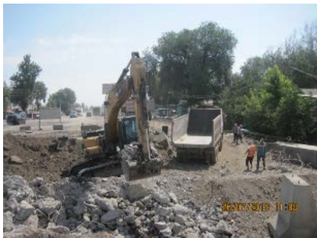
Рисунок 31 Строительные отходы при строительстве моста
