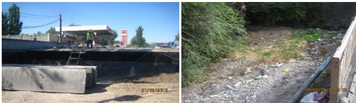
Рисунок 35 Нарушения техники безопасности при строительстве моста на канале Крепостной
