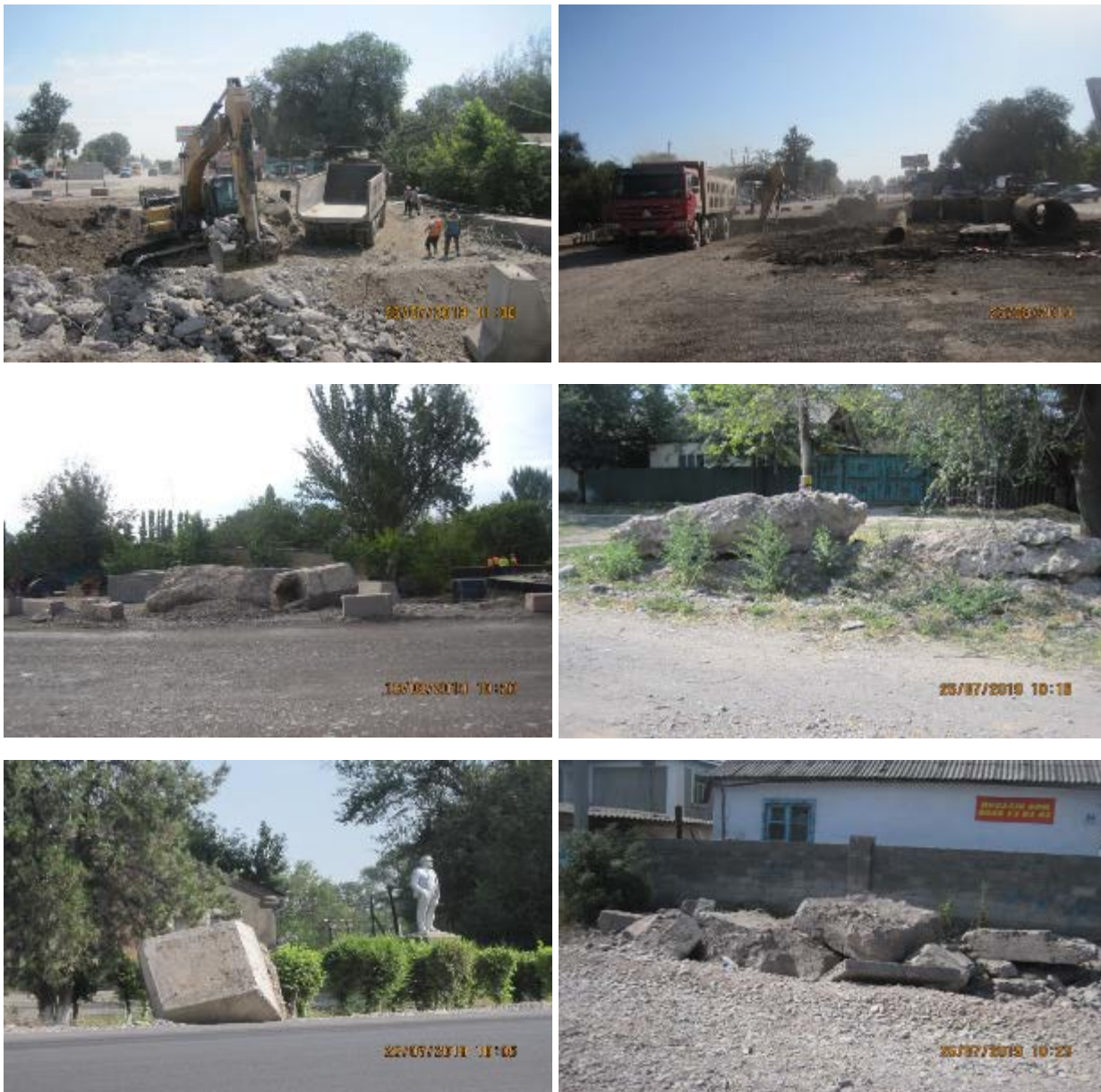
Рисунок 48 Проблема строительных отходов на дороге
