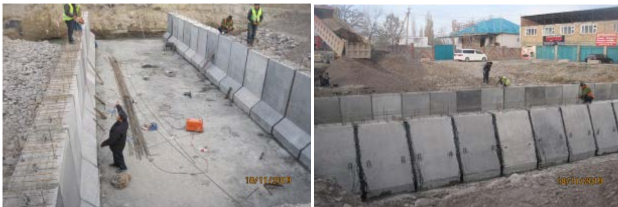
Рисунок 37 Нарушения техники безопасности при строительстве моста на канале Жантай
