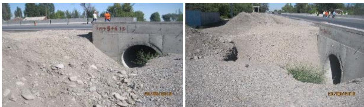
Рисунок 28 Нарушения на построенных ранее сооружениях
