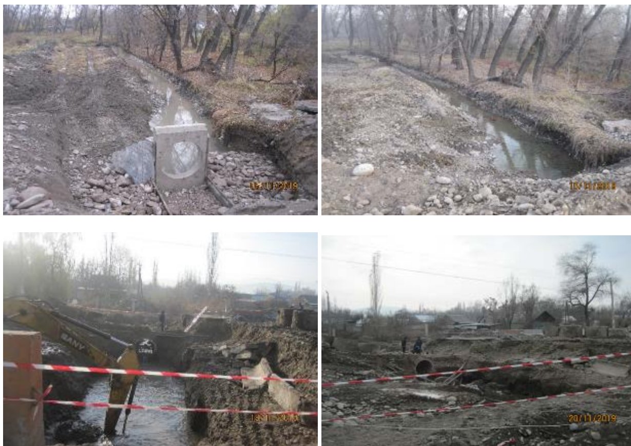
Рисунок 30 Выклинивание грунтовых вод при строительстве водопропускных труб
