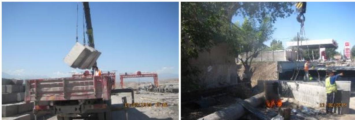
Рисунок 69 Нарушения техники безопасности при перемещении грузов подъемным краном
