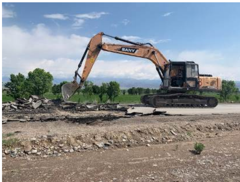
Фото 28. Кирковка асфальтобетонного покрытия на км. 74+550
