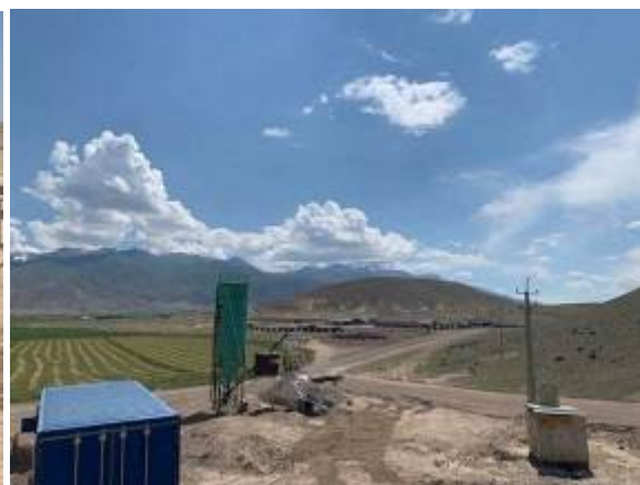
Фото 73. Состояние производственной площадки ДСУ и подъездных путей после полива водой.
