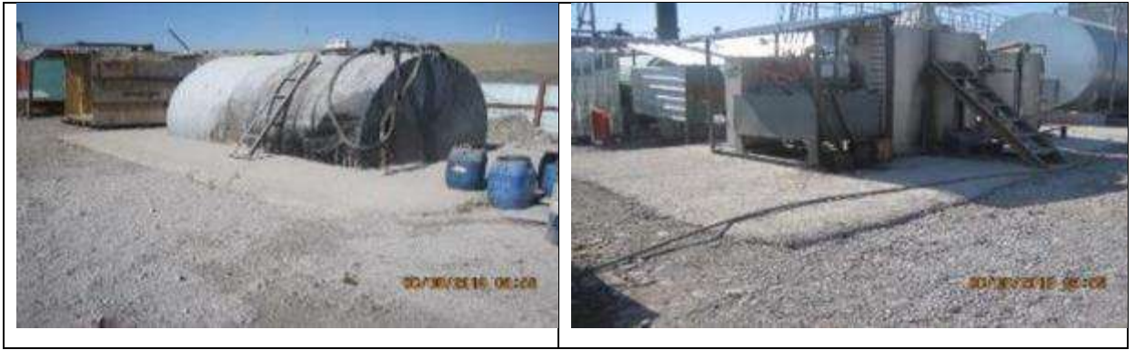
Рисунок 53 Непроницаемое защитное покрытие вокруг емкостей с химическими растворами.
