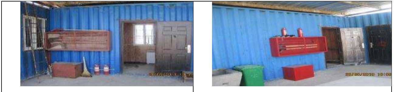
Рисунок 64 Противопожарные щиты на территории лагеря
