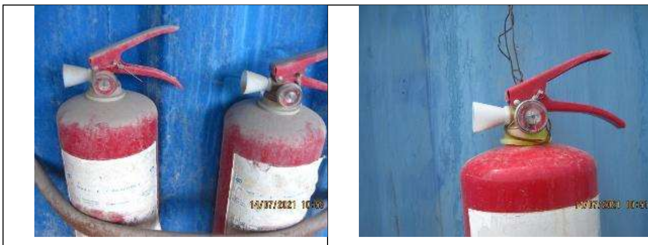
Рисунок 66 Огнетушители, установленные с нарушениями на территории промплощадки.
