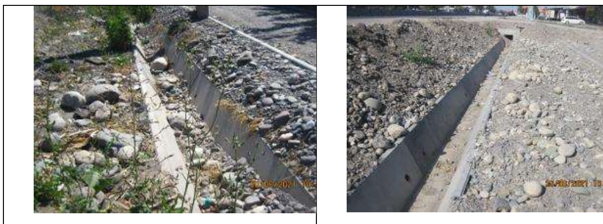
Рисунок 48 Состояние ранее установленных лотков до и после очистки.
