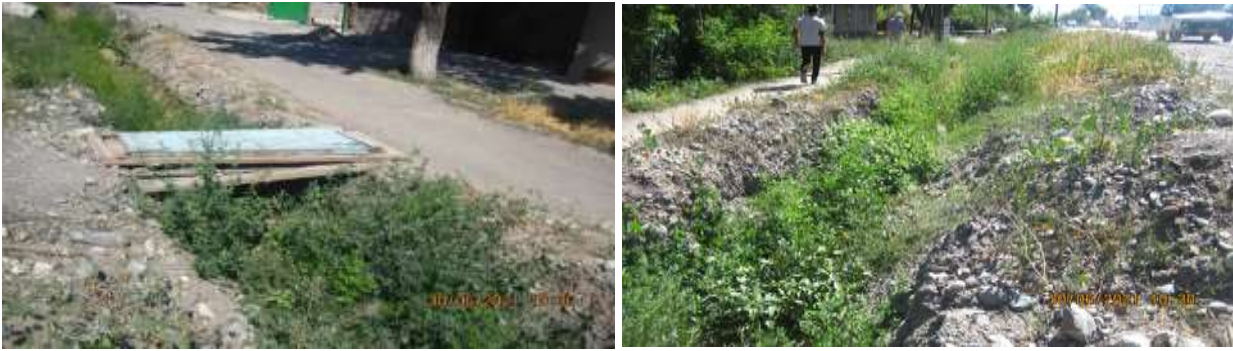
Рисунок 35 Ранее выкопанная и заброшенная траншея для водопропускных лотков
