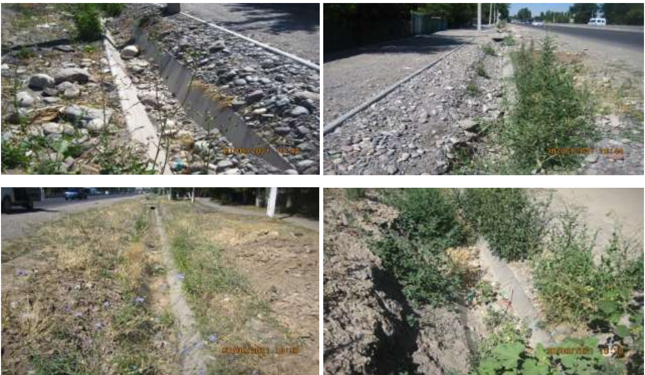
Рисунок 34 Состояние ранее установленных лотков
