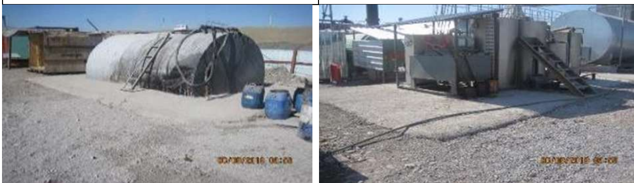
Рисунок 43 Непроницаемое защитное покрытие вокруг емкостей с химическими растворами
