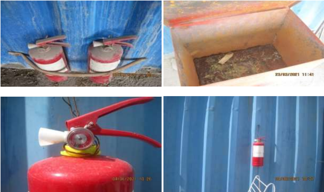
Рисунок 54 Огнетушители, установленные с нарушениями на территории промплощадки
