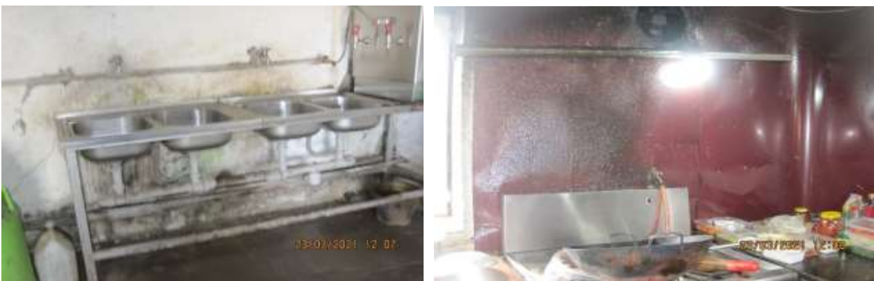
Рисунок 55 Неудовлетворительное состояние кухонного блока на территории базы в с. Беловодское
