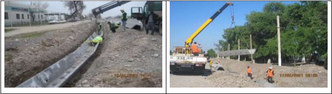
Рисунок 33 Установка водопропускных лотков с нарушением техники безопасности.
