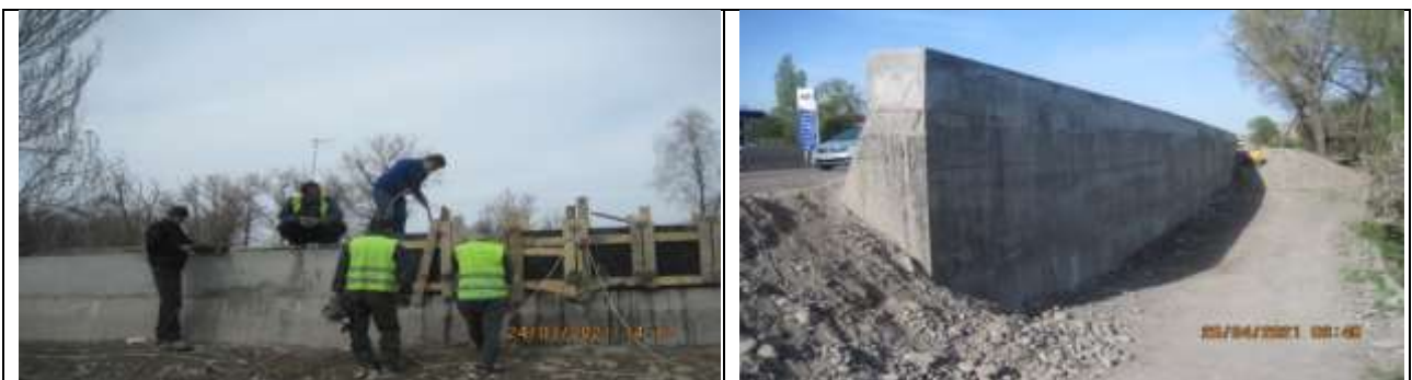
Рисунок 38 Нарушение техники безопасности при работе на высоте
