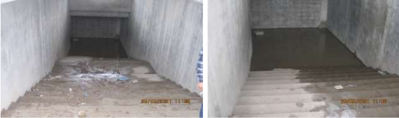
Рисунок 39 Подтопление подземного перехода на км 57+420 в период дождей в марте 2021 года
