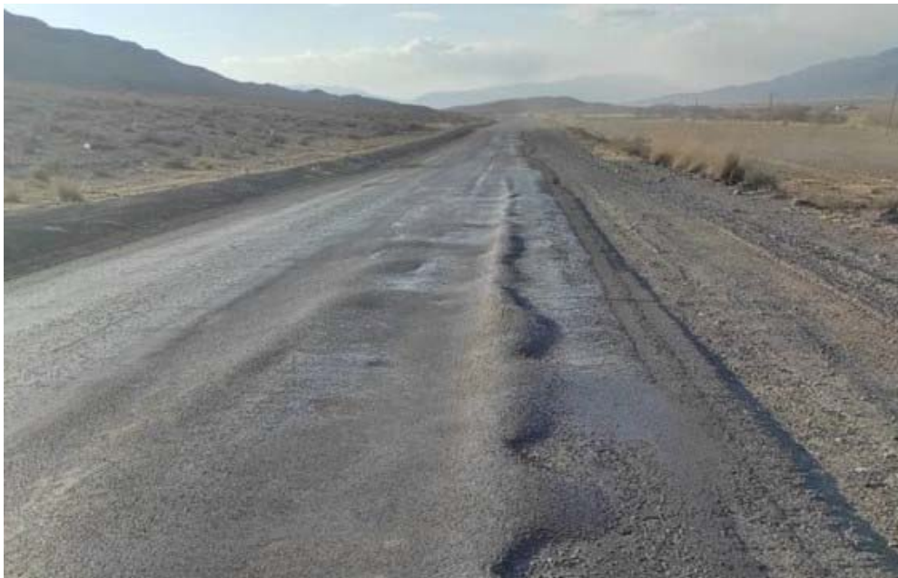
Фото № 8 Подрядчик инструктирован по ремонту участков дороги на 2-м Лоте между Кочкор-Эпкин (км 62,4 - км 89,5), с сильно изрезанной келейностью представляет угрозу безопасности (4 февраля 2021 г.)
